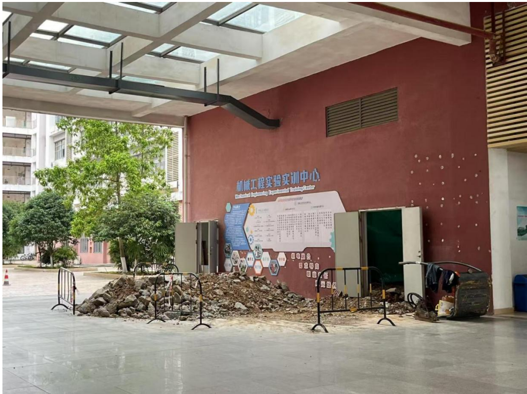
第一实训楼新建变电站
