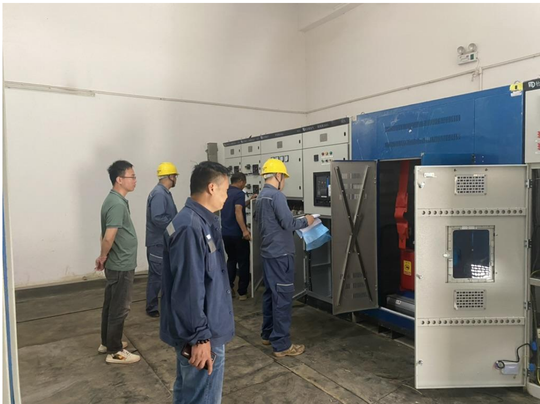
供电局对变压器设备进行送电前的参数核对
