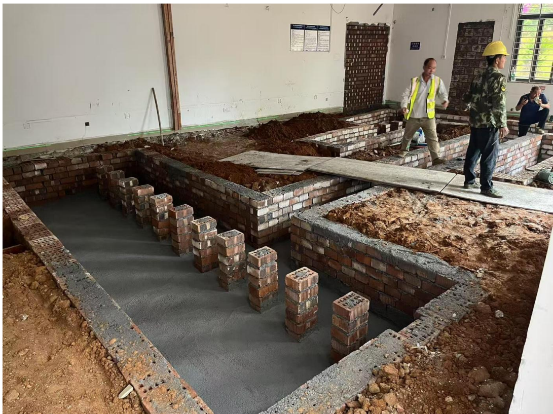
第二实训楼新建变电站
