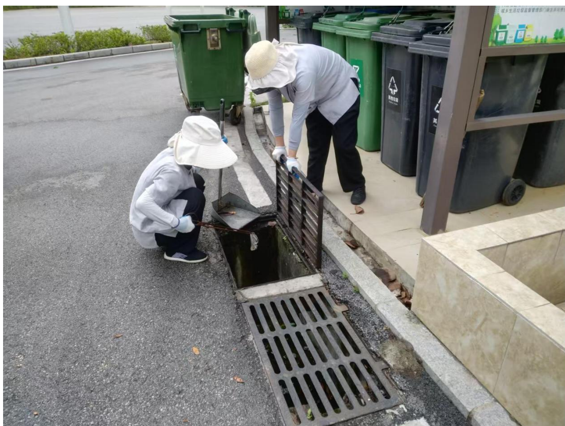
清洁地面排水管网
