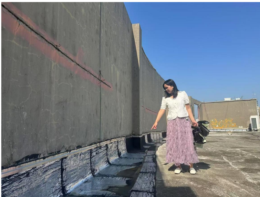
现场检查图书馆第一教学楼渗漏水情况
