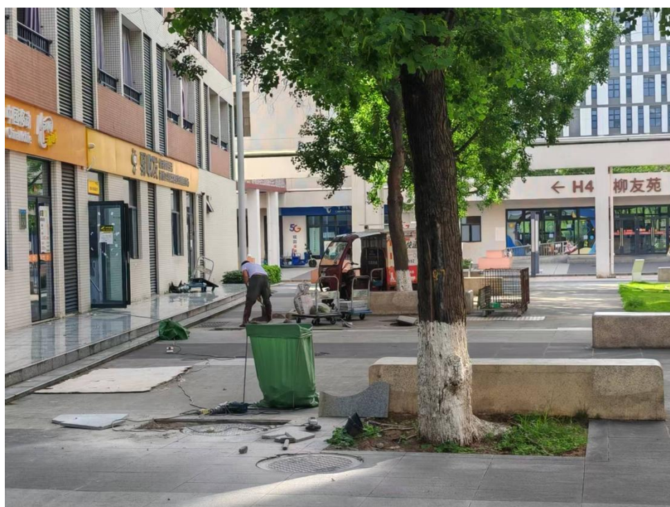
北校区快递门面前路面破损自行安排维修
