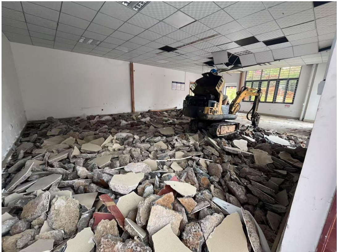
第二实训楼新建变电站
