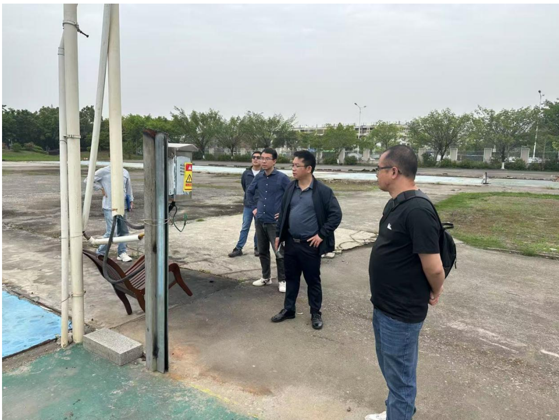
对南校区线路裸露问题进行检查
