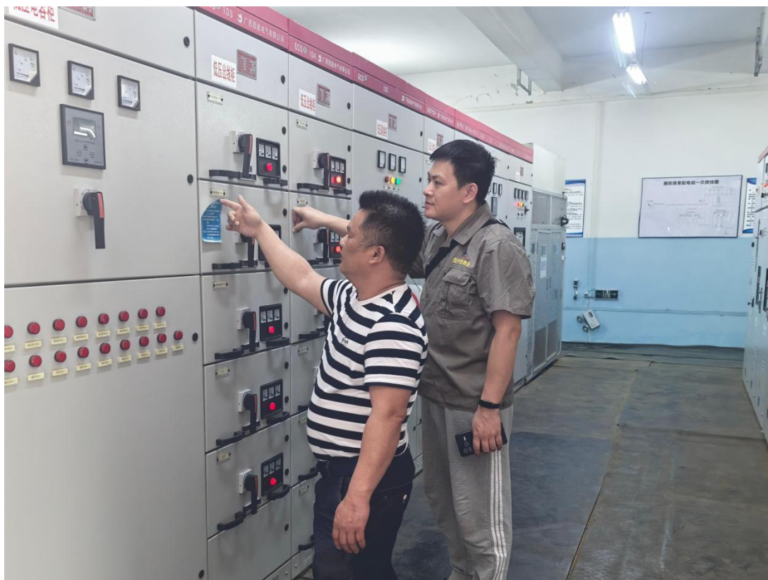
对第十栋高压配电房的高压设备进行例行检查
